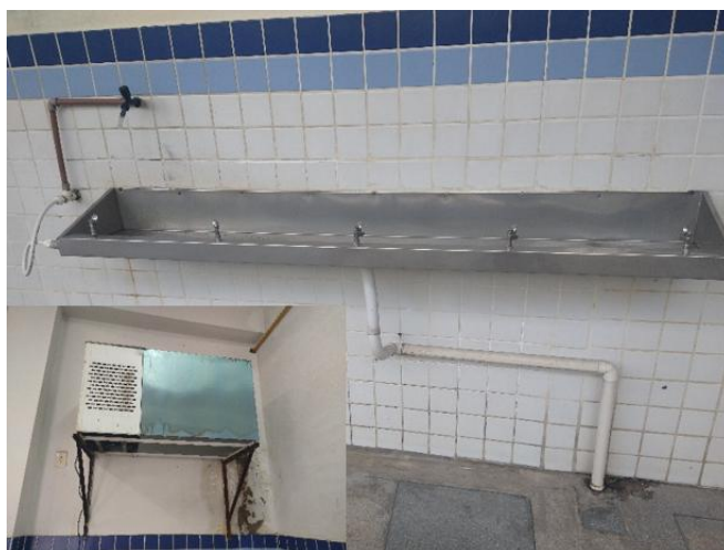
Figura 3: P2 (torneira do bebedouro e filtro no canto inferior esquerdo).
